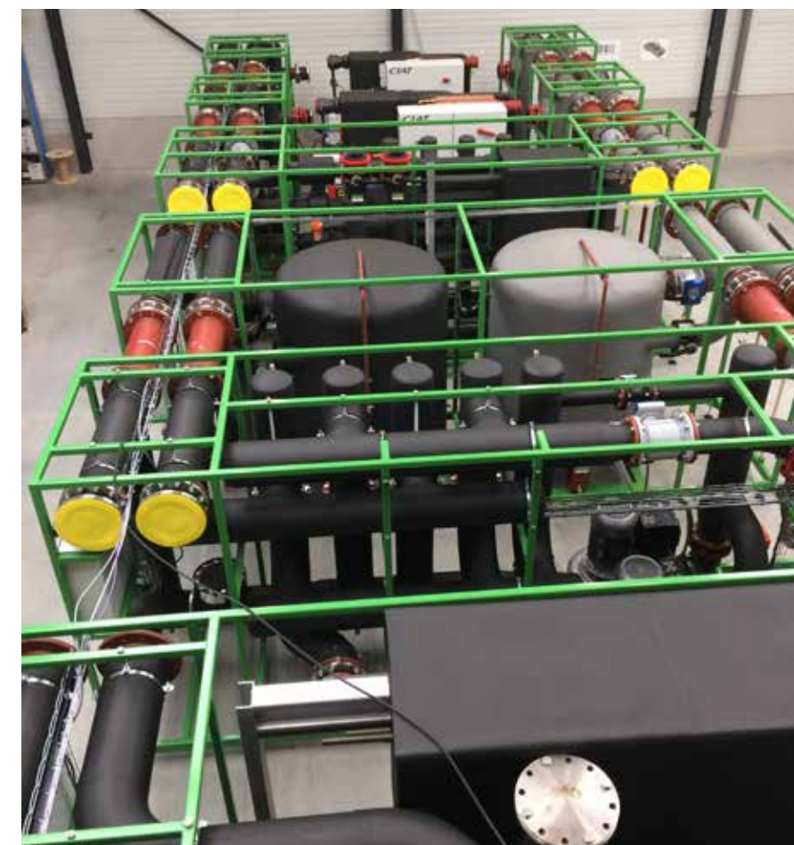
De door CIAT Nederland geleverde warmtepompen als onderdelen van de complete WKO-installatie.
