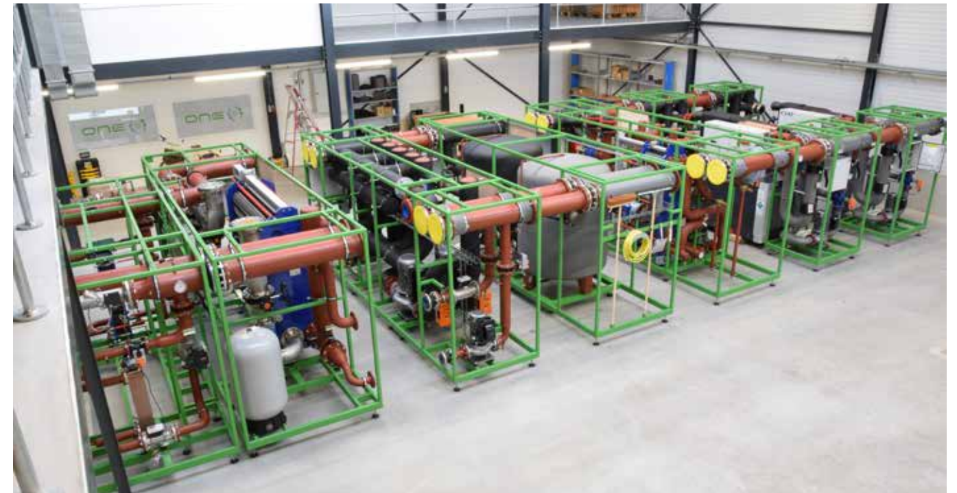
De complete WKO-installatie.
